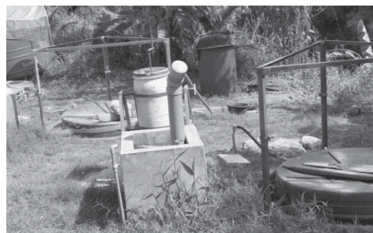
図 1 王立農業大学内の 3 連メタン発酵槽
